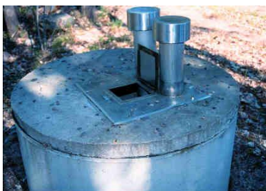
Brunnslocket, ventilationsrör och provtagningsluckan. Foto: Toivo Lapinlampi
