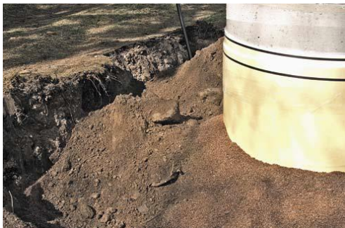
Schaktbrunns värmeisolering. Foto: Tuomo Hatva
